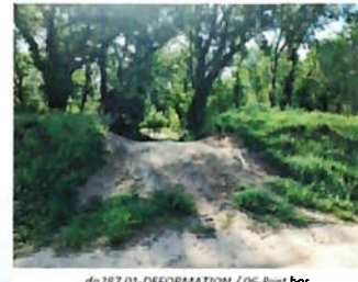
dp287 01-DEFORMATION / 06-Pont bas
